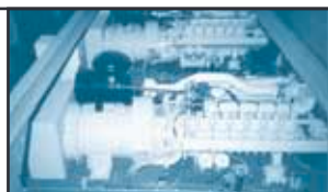
BHKW St. Ingbert
